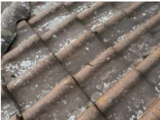
Tuiles et faîtières cassées
